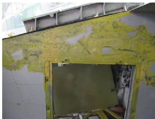
Рис.2. Повреждения верхней панели гондолы левого двигателя. Селективная коррозия: глубина повреждений 0,2 мм, материал Д16АТ, толщина листа 1,0 мм
