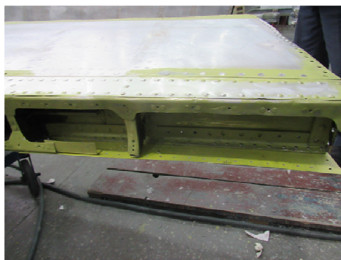
Рис.8. Повреждения заднего лонжерона правого стабилизатора. Селективная коррозия: глубина до сквозной, материал Д16Т, толщина 1,5 мм
