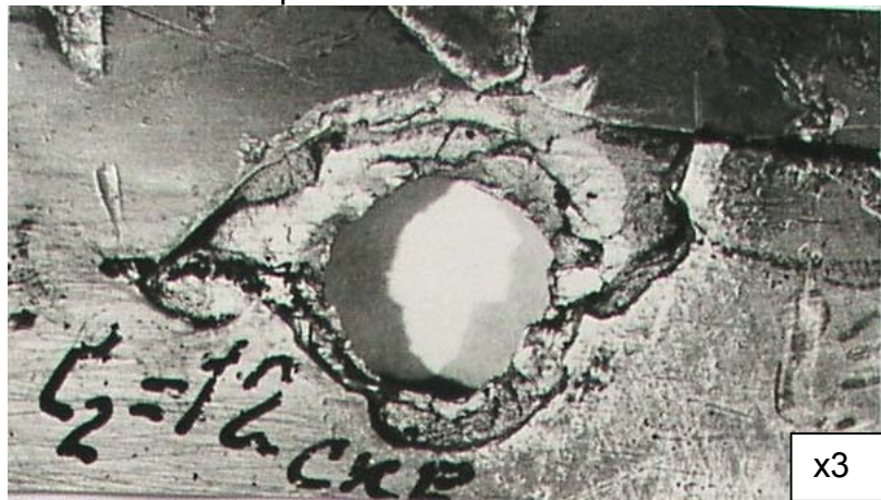
Рис. 2. Коррозия верхней панели центроплана самолета Ан-24 у зенкованного отверстия после 18 лет эксплуатации в условиях влажных тропиков (x3).
